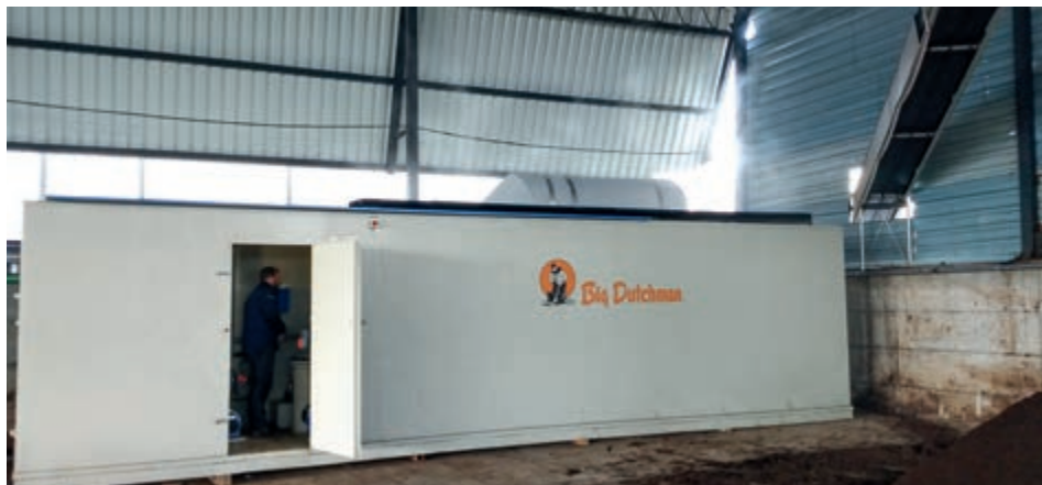
Поглед към очистителя за мръсен въздух като комплексната система готова за свързване
