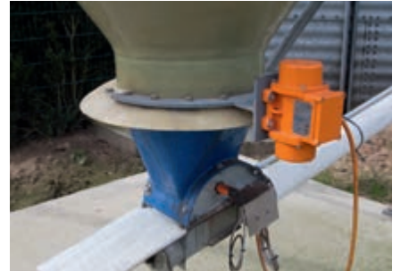
Silo mit elektrischem Rüttler
