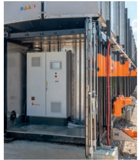
Автоматизированное управление системой
