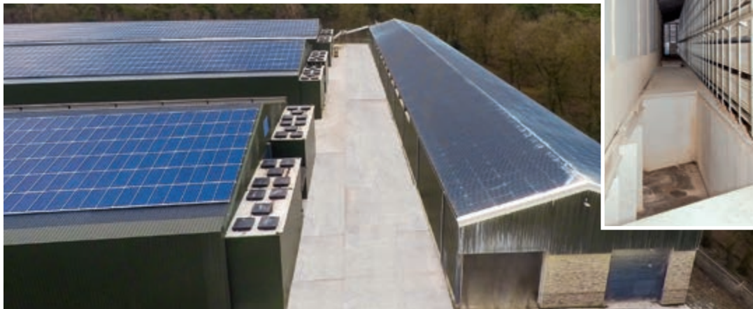
Kosteneffiziente Lösung: Ein OptiSec für drei Legehäuser mit jeweils 90.000 Legehennen; die Luft wird unterirdisch zum Trockner geleitet
