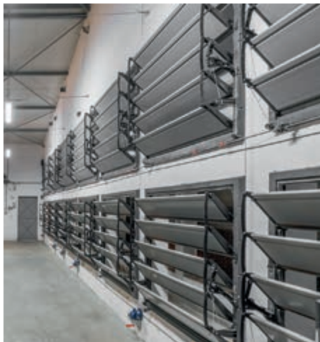
MultiVent 17 M in der Giebelwand für Tunnelventilation
