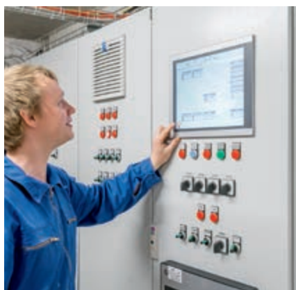
15" großes Touchdisplay im amacs-Schaltschrank
