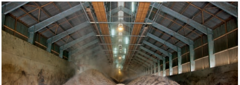
Vista de una instalación de distribución como sistema de distribución de desplazamiento longitudinal con dos cintas de distribución
