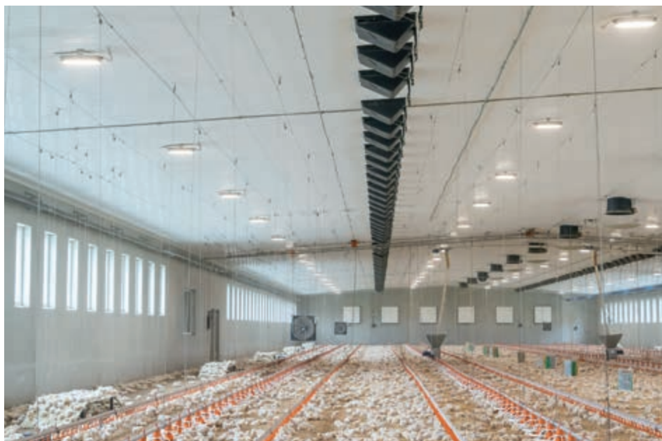
Uso de la entrada de techo CL 1540 en el falso techo de una nave de pollos de engorde
