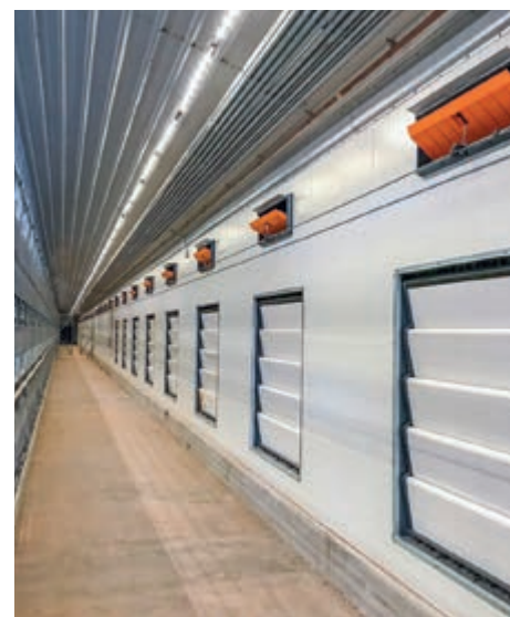
Volière avec ventilation CombiTunnel utilisant des volets à bride CL-3-1911/F et MVT shutters
