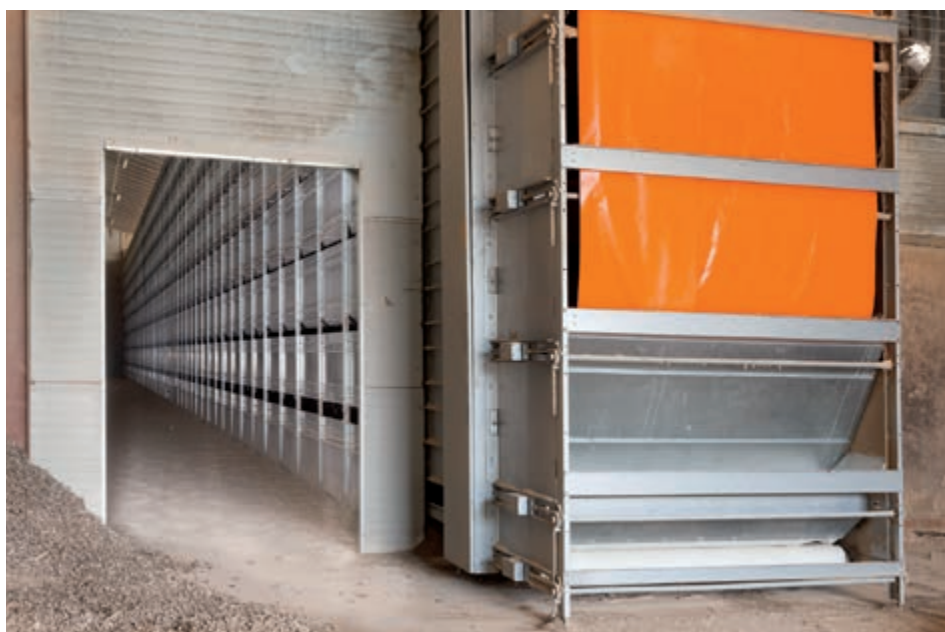
16-piętrowy tunel do suszenia pomiotu OptiSec
