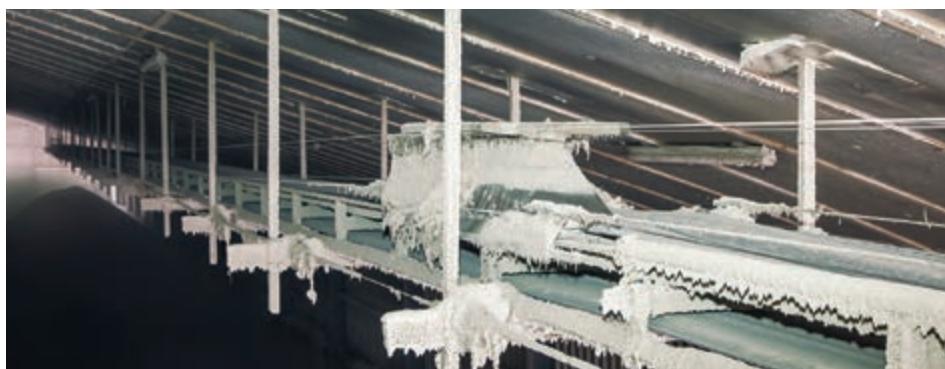
Widok na taśmę rozdzielającą ze zgarniaczem pługowym
