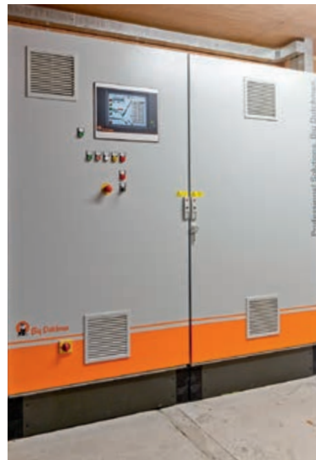
Szafa sterownicza z modulem funkcyjnym amacs „Tunelowe suszenie pomiotu OptiSec”
