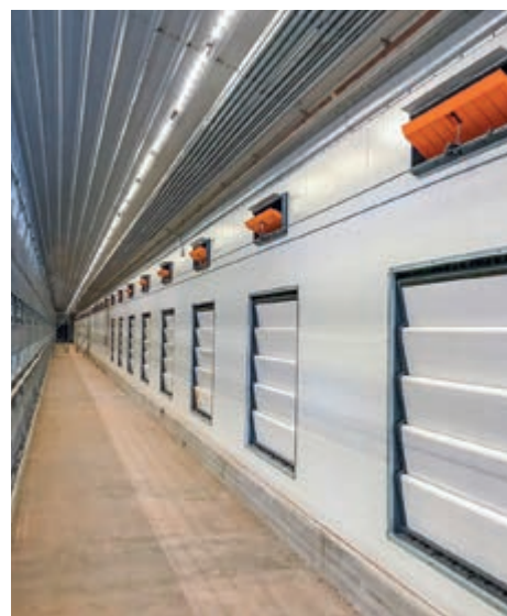
Kurnik z wentylacją CombiTunnel, wyposażony w wloty kolnierzowe CL-3-1911/F i żaluzje MVT
