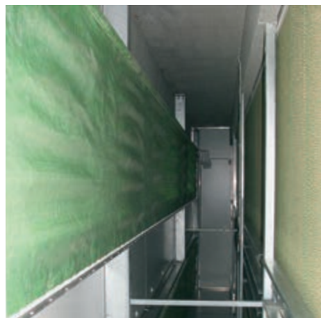
Туннельное отверстие с электроприводными жалюзи
