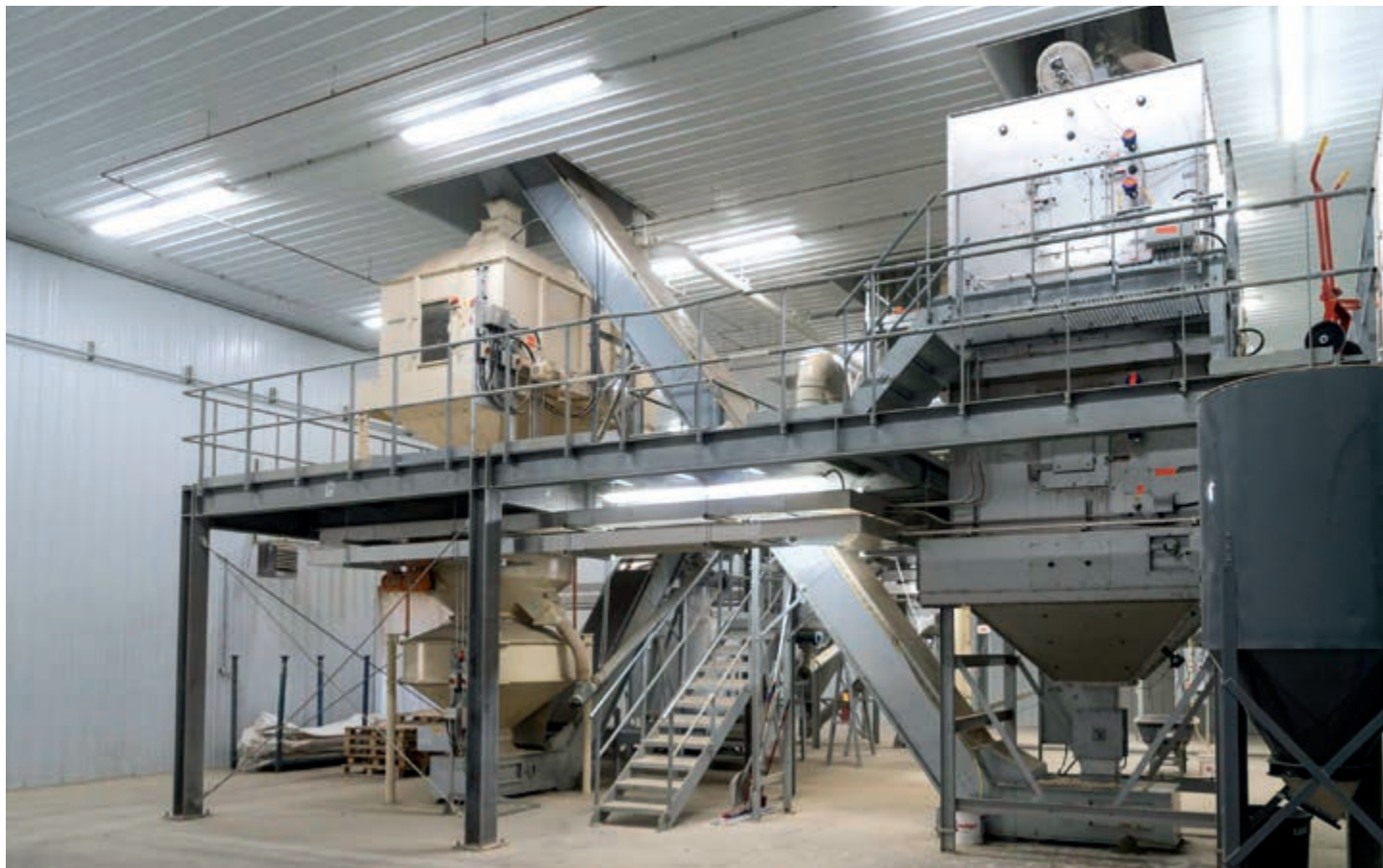
BD PelletTower с устройством для обеззараживания на 600 000 кур-несушек
