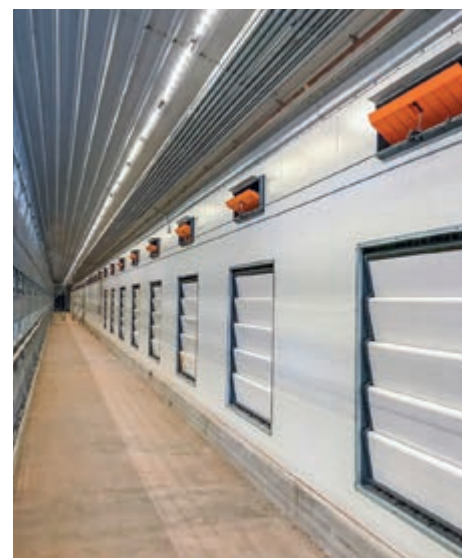
Пташник з вентиляцією CombiTunnel, обладнаний фланцевими припливними клапанами CL-3-1911/F та заслінками MVT
