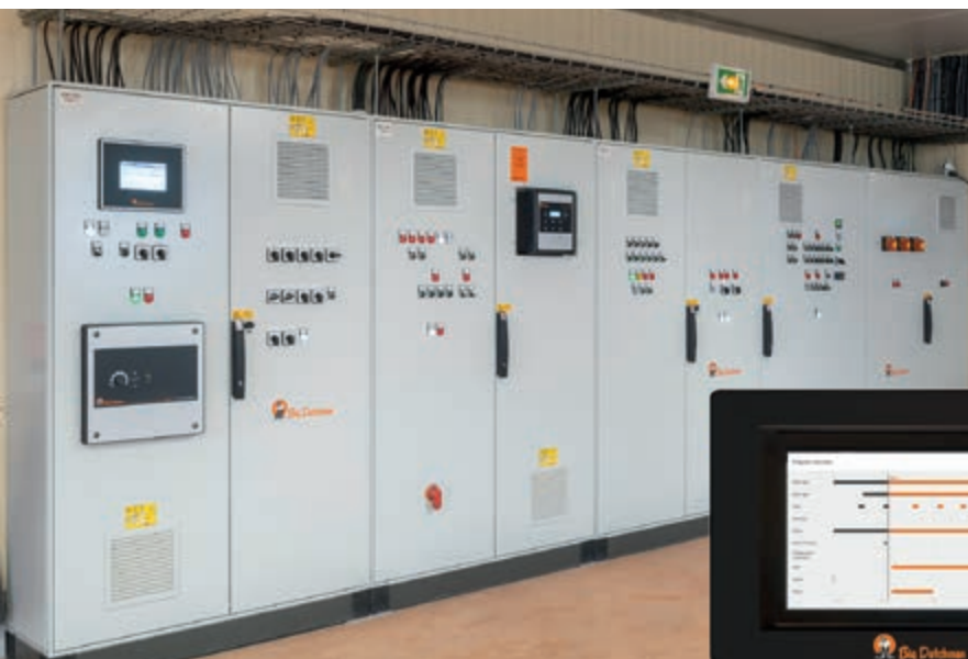
Moderner Schaltschrank: übersichtlicher Aufbau, einfache Bedienung, hoher Schutzgrad, ansprechendes Aussehen
