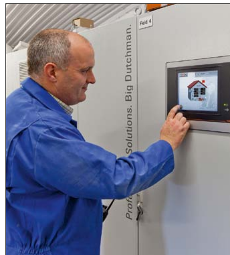
L'écran tactile supplémentaire est intégré à l'armoire de commande
