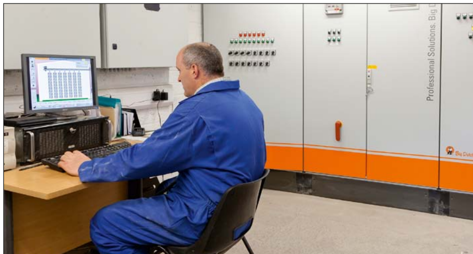
L'éleveur contrôle l'ensemble de ses poulaillers sur son écran – les consignes s'appliquent directement dans chaque bâtiment
