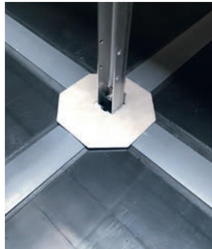
Stojaki woliery przy pomocy stóp ze stali nierdzewnej są montowane stabilnie do sufitu pośredniego
