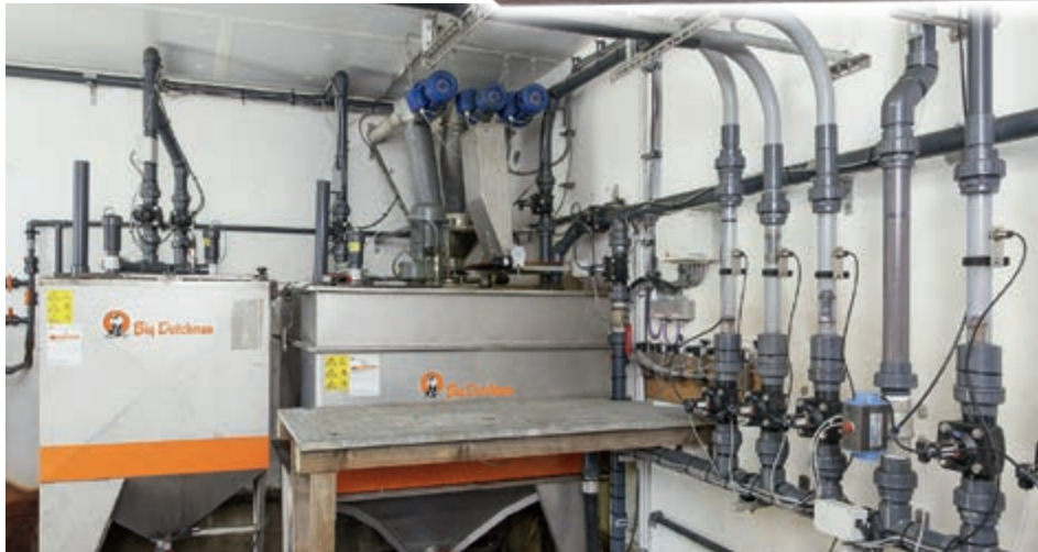
1-Tank-Anlage mit Brauchwassertank und vier JET-Stichen
