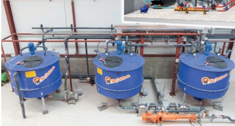
2-Tank-Anlage mit Brauchwassertank
