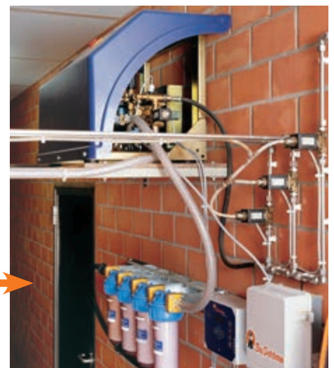
Zentrale Pumpeneinheit mit 4-stufigem Filter
