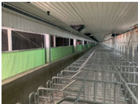
Deckzentrum mit Rollgardine und RainMaker bei Cross-Tunnel-Ventilation
