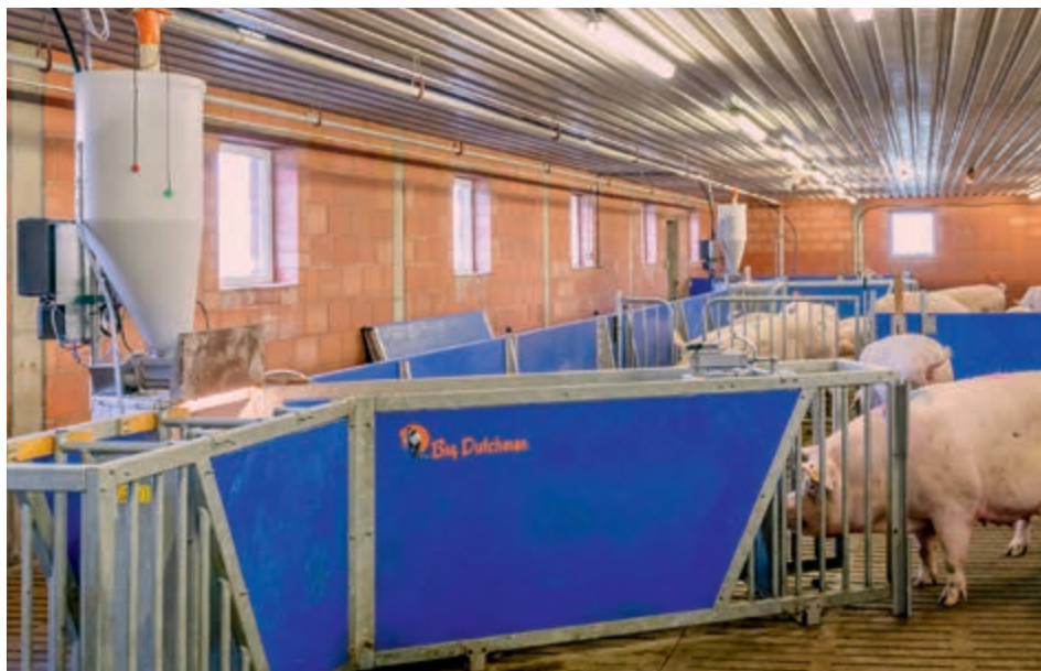
Einsatz der DiffAir-Decke in einem Wartestall für Sauen
