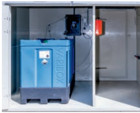
Säurelager und Säuredosierung
