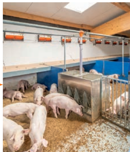
El aire fresco circula homogéneamente, sin corrientes, en la nave
