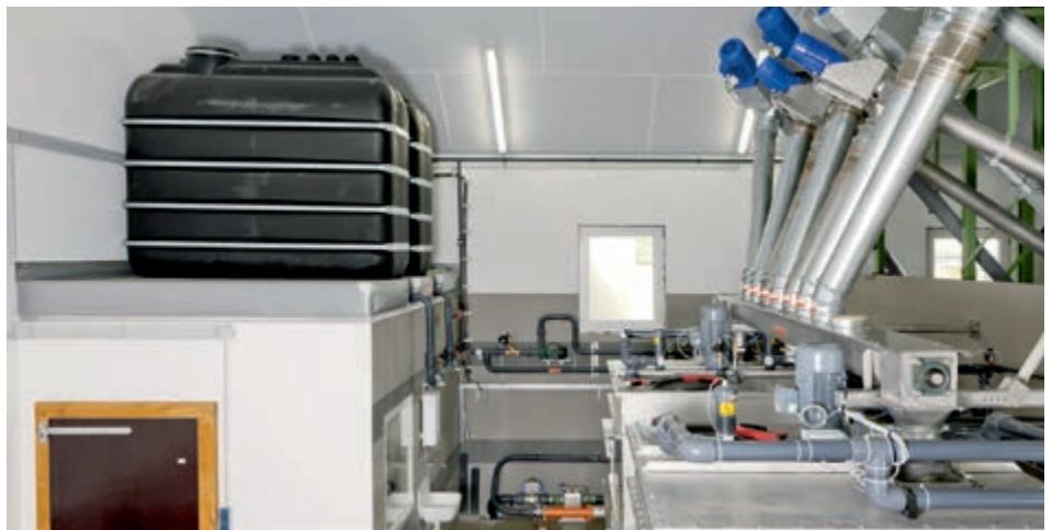
Cocina de alimentación con dos tanques para alimentación sin restos y dos tanques de agua limpia de 2000 l.
