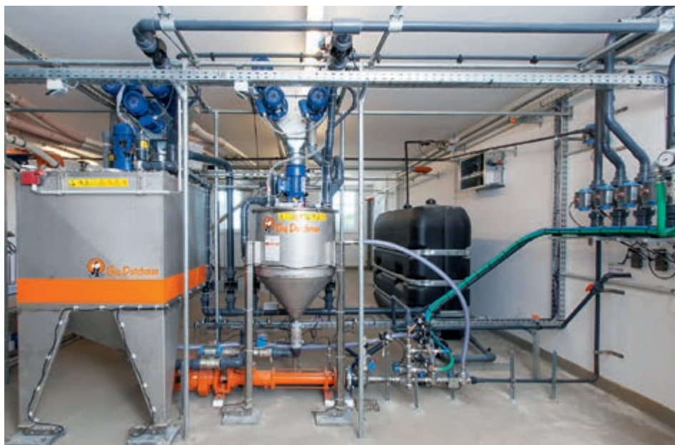
Sistema de 2 tanques con tanque pequeño y tanque grande
