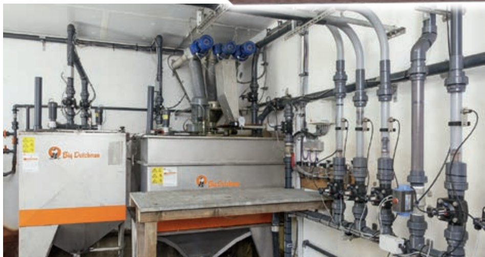
Sistema de 1 tanque con tanque de agua usada y cuatro líneas JET
