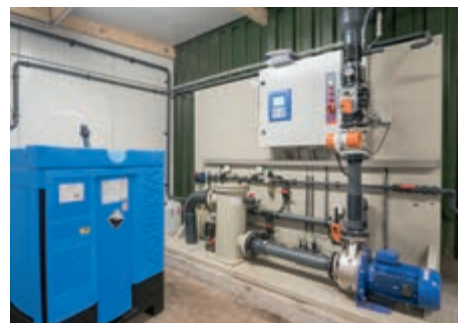
Pomieszczenie techniczne z pojemnikiem na kwas
